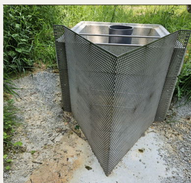
Grilles inox en V sur prise d'eau
